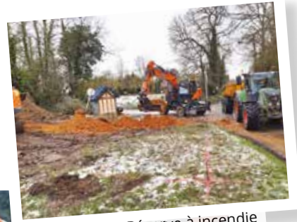
Réserve à incendie rue Sadi Carnot
